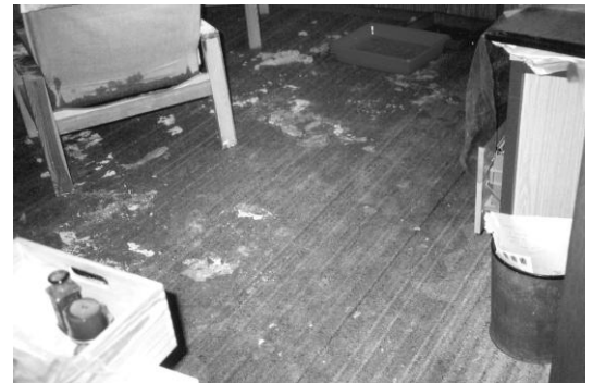
Die Nässeschäden in Gängen und Büros...
