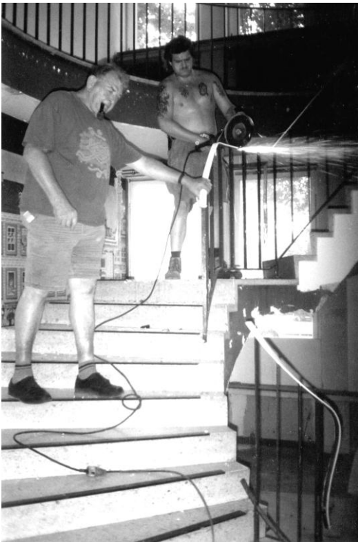
Mit Herrn Schmittl vom Bauhaus beim Abriss der Wendeltreppe vom unteren zum oberen Foyer
